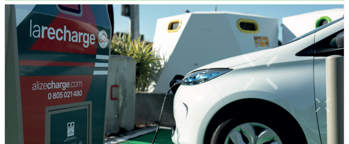
BORNE DE RECHARGE PUBLIQUE DE VÉHICULES ÉLECTRIQUES
